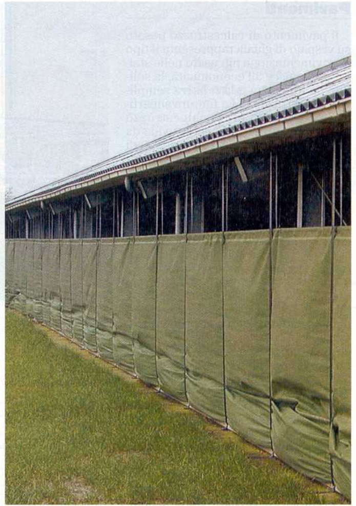
Foto 9 - Telo di materiale plastico installato lungo la parete longitudinale della stalla
